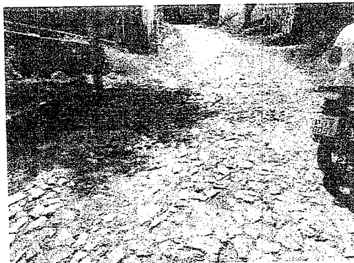
Foto 8 – Calçamento a recuperar na Torre Da Lua
